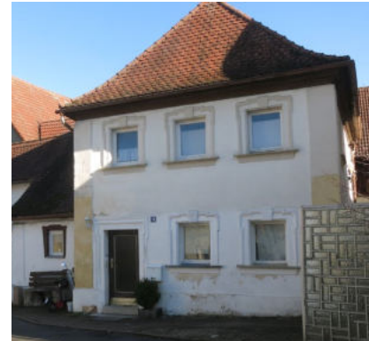
Abb.23: Schlechter Gebäudezustand, Hauptstr. 14
